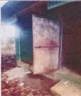
Foto 3: Observamos el modulo del baño con puertas en mal estado.
