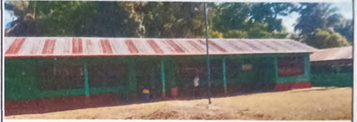
Foto 2: Se observa el modulo 2 y 3 con deterioro en su entechado.
