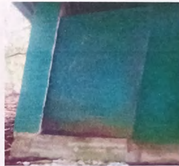
Foto 4: Baños en mal estado.
