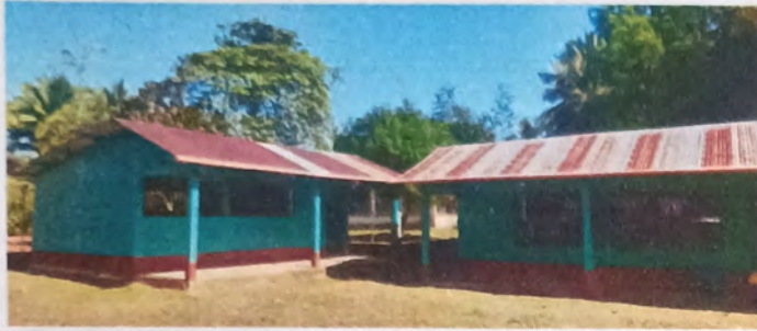
Foto 1: Se observa el modulo 1 con deterioro en su techo.
